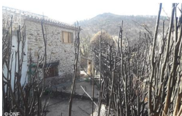
Haie attenante à la maison ayant contribué à la propagation du feu par la fenêtre de l'étage, malgré le bon niveau de débroussaillage avant la haie
