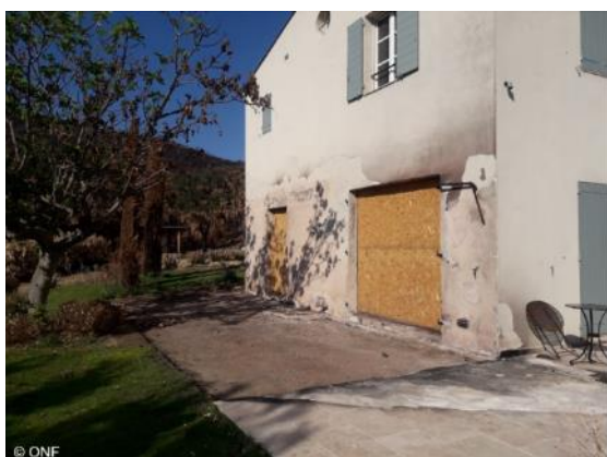
Maison bien débroussaillée mais détruite du fait de la propagation du feu par terrasse bois et baie vitrée.
